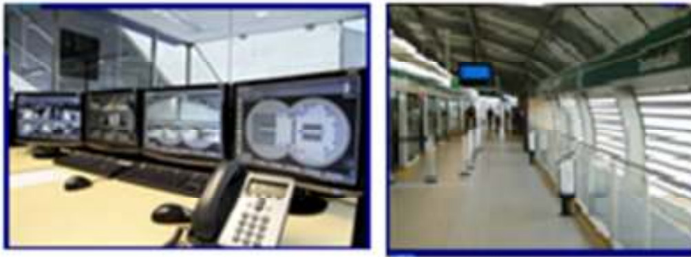
Fig.4 Sistema de CFTV IP, Telefones IP e sistema Multimídia; Utilizando a tecnologia de redes de fibra óptica e cabos metálicos.
