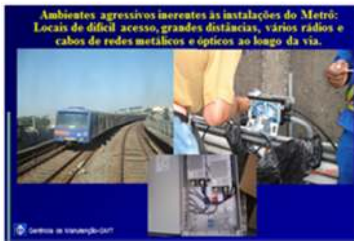
Fig.11 Exemplo de ambiente agressivo inerente às instalações do Metrô; posicionamento dos cabos e rádios ao longo da via.
