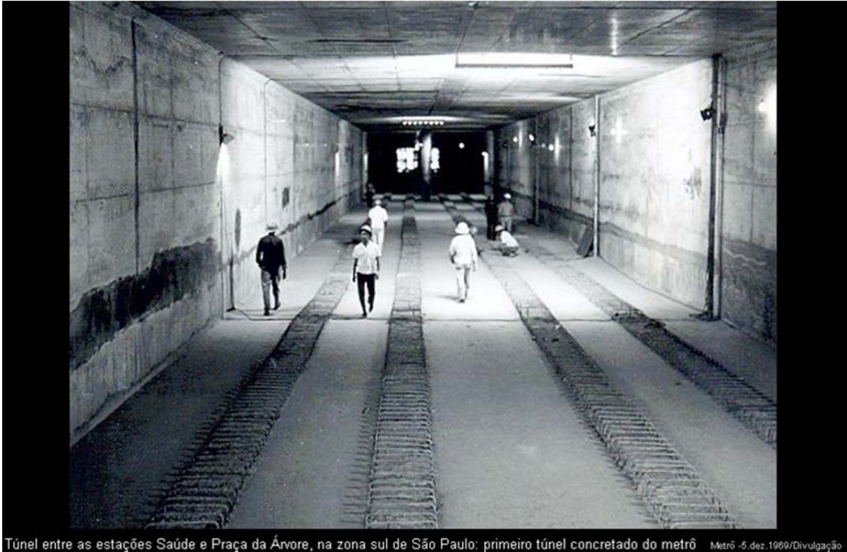
Figura 2: Túnel entre as estações Saúde e Praça da Árvore, na zona sul de São Paulo
