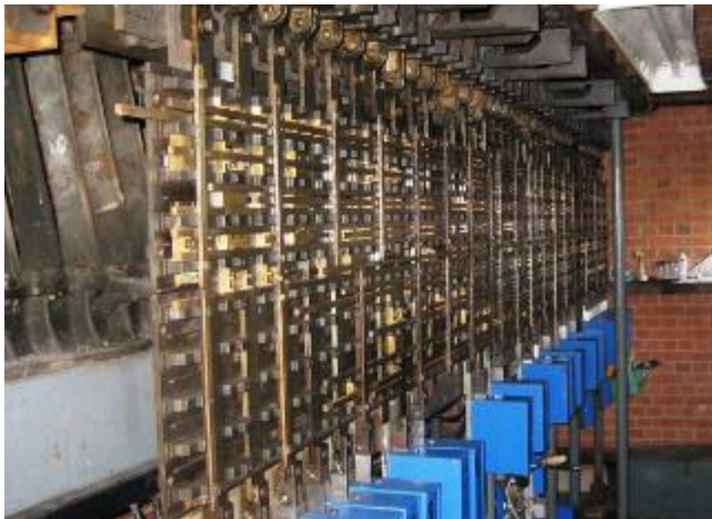
Intertravamento mecânico; Signal Box - Bishops Bridge
